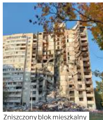
Zniszczony blok mieszkalny
